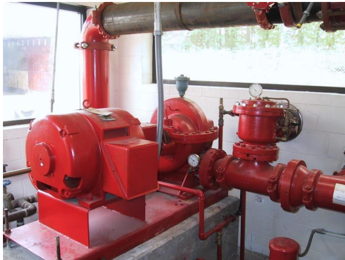
Gambar 6.3.5.1 – Pompa kebakaran digerakkan dengan listrik
