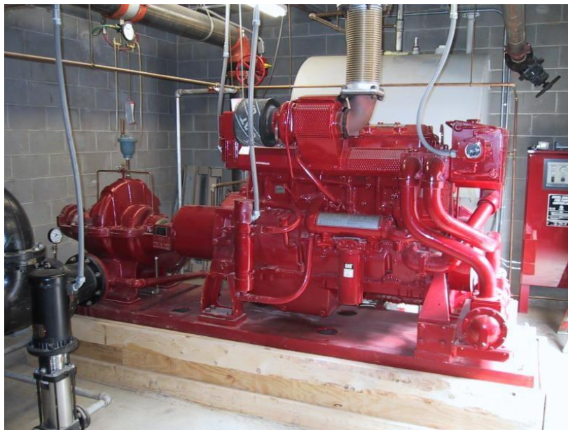
Gambar 6.3.5.2 – Pompa Kebakaran digerakkan dengan Diesel
