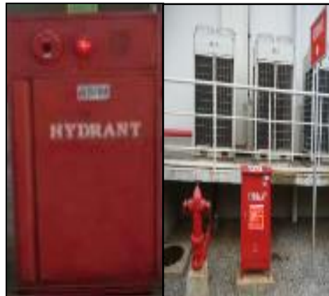
Gambar 4.18 Hidran Sumber: Dokumen PT X
